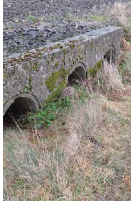
Dispositif de gestion des eaux pluviales
